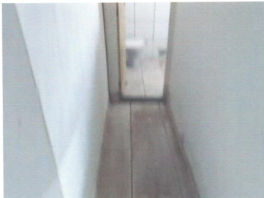
ACESSO AO BANHEIRO COM MENOS DE 80cm
