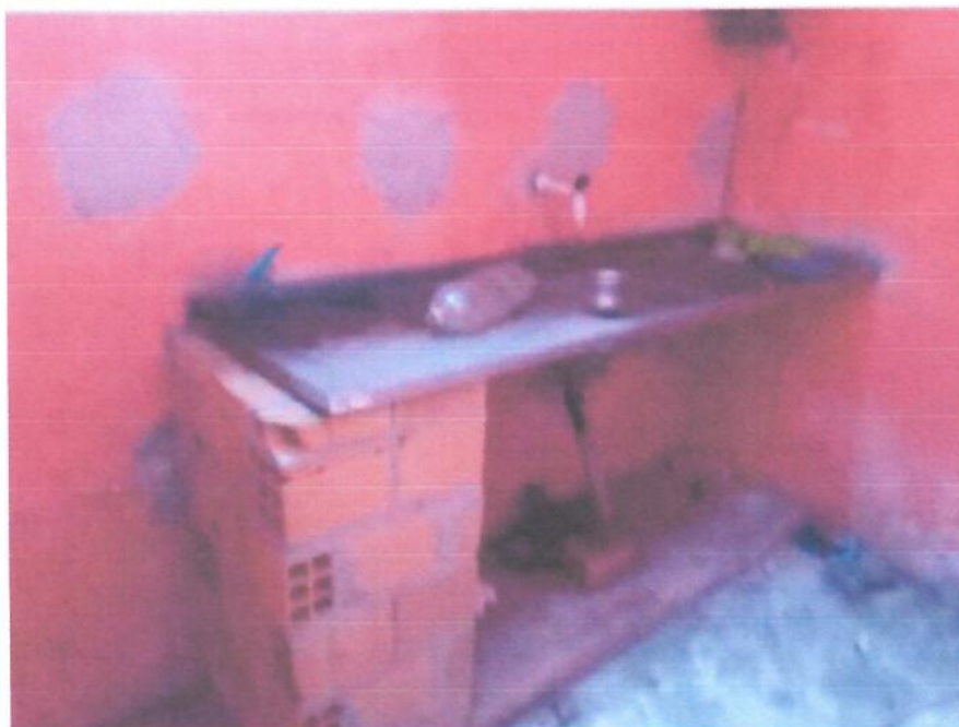
COPA: - SEM CONDIÇÕES DE FUNCIONAMENTO
