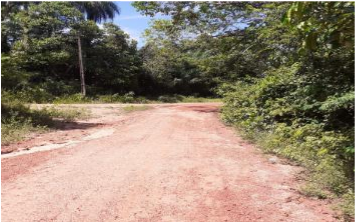
Imagem 11- mostra curva acentuada próximo a localidade de Cumií e Candeuba, com registro de vários acidentes ao longo dos anos.
