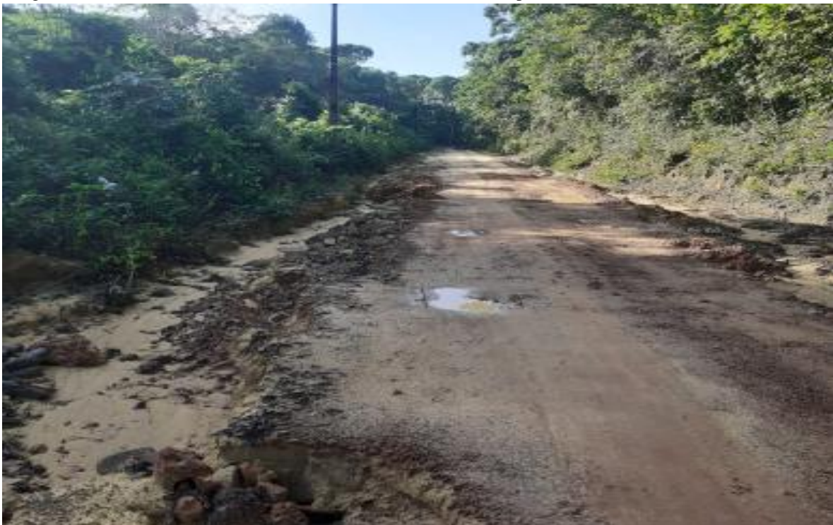
Imagem 02- mostra trecho acidentado de acesso a localidade de Jenipauba da laura.
