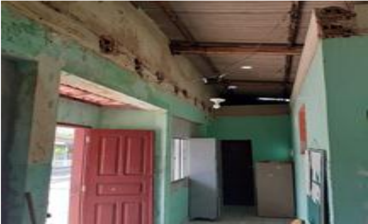
Imagem 02- mostra a condição atual do forro e telhado do prédio da VISA.
