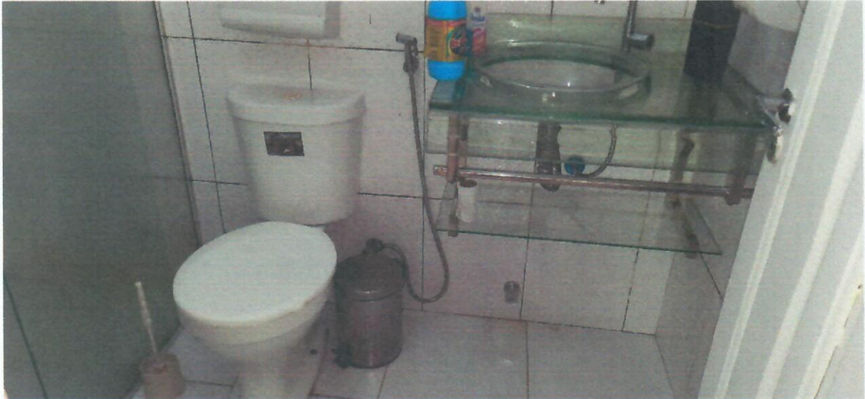
Foto 23 – Vaso e lavatório do banheiro da sala 03
