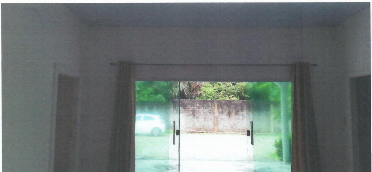
Foto 12 – Parede e forro da sala 01
