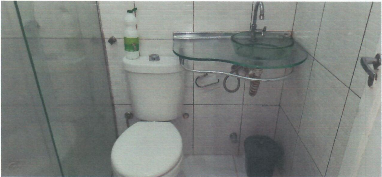
Foto 27 – Vaso e lavatório do banheiro da sala 06
