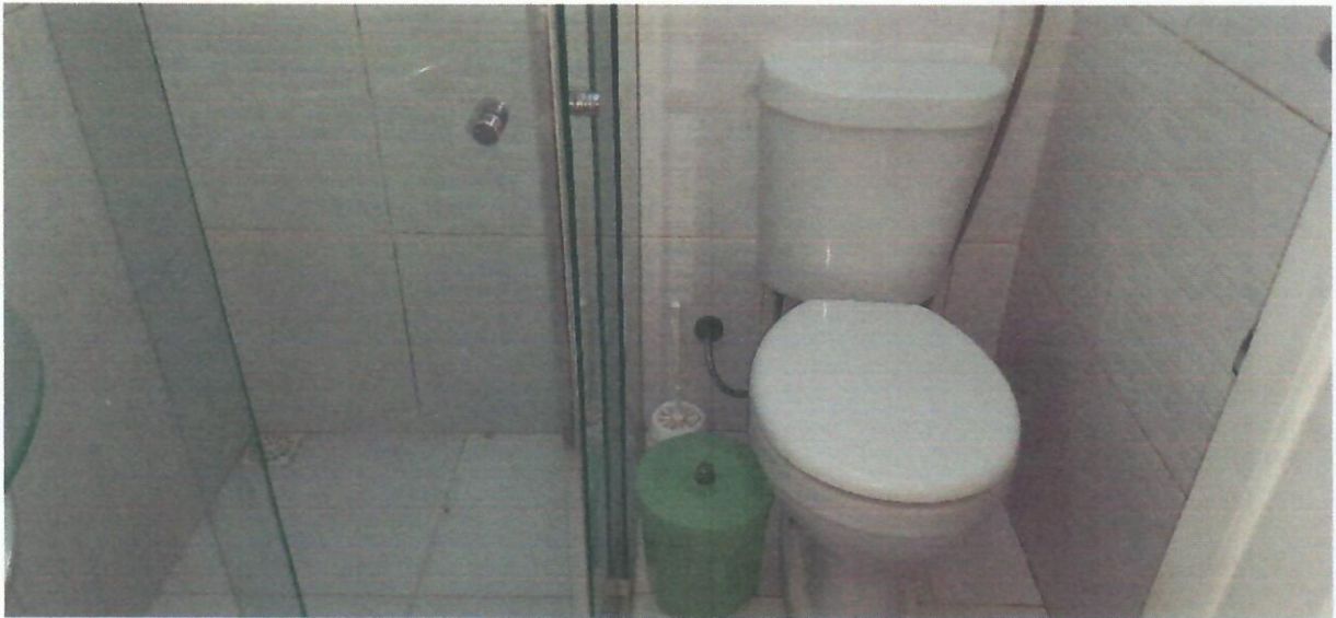
Foto 21 – Vaso e Box do banheiro social
