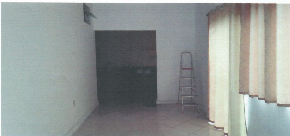
Foto 08 – Piso e parede da sala 04
