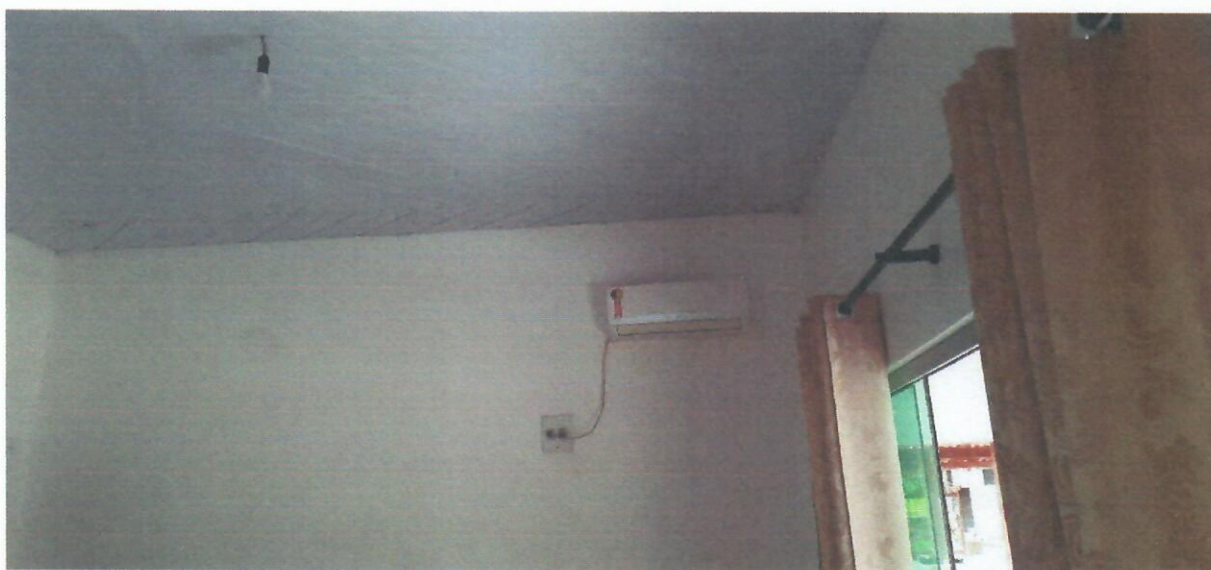
Foto 14 – Parede e forro da sala 03
